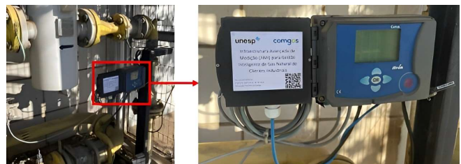
Fig. 2. AMI instalada em parceiro. Destaque para invólucro do dispositivo LoRaWAN acoplado ao corretor de volume de gás natural. QR Code fornece acesso à interface de gestão inteligente da AMI
