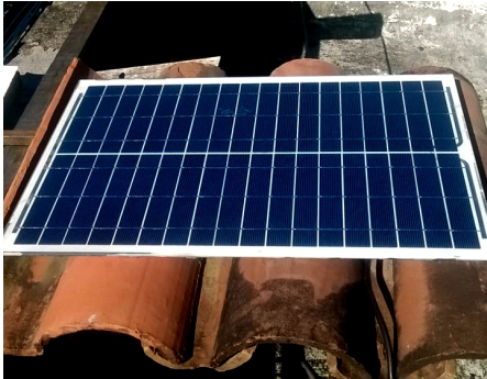
Fig. 5. Módulo FV modelo KS20T de 20 Wp instalado no telhado.
