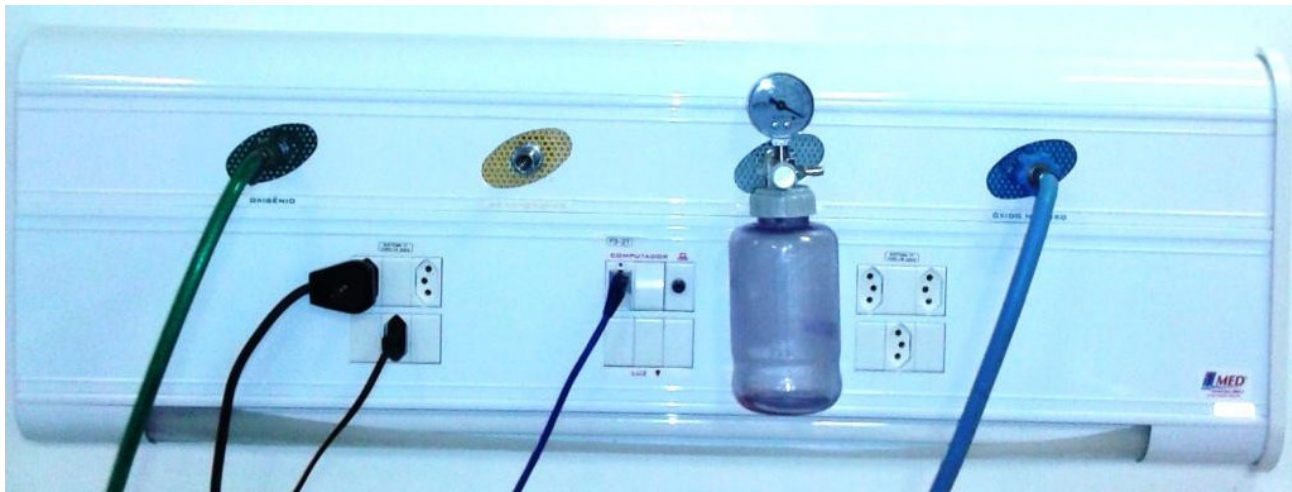
Fig. 3. Visão frontal do painel que contém as tomadas elétricas monitoradas.
