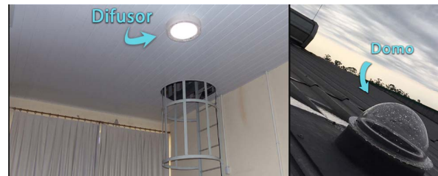
Fig. 6. Demonstrativo do sistema instalado (difusor e domo).
