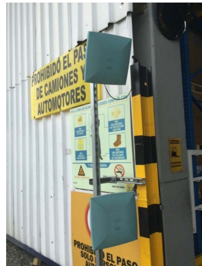
Fig. 5. Antenas Simatic-RF660A en el portal de lectura RFID.
